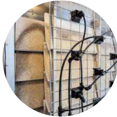
Zentrale Luftbefeuchtung in der RLT-Anlage
