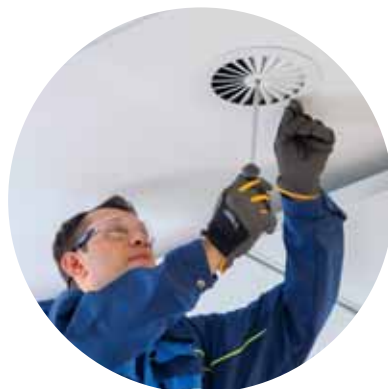
Einregulierung am Luftdurchlass
