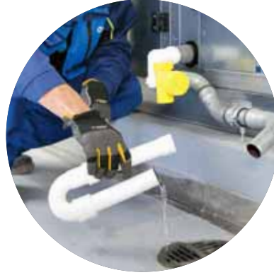
Kondensatwasserentleerung aus einem Syphon
